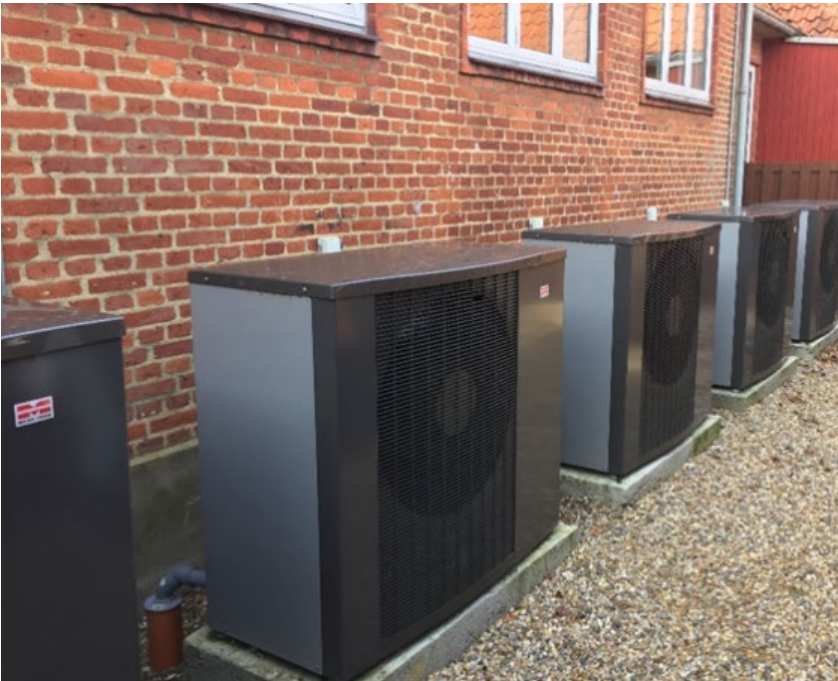
Figur 2 Gashybridanlæg ved Gredstedbro Skoles hovedbygning (fem luft/vand-varmepumpers udedele).
